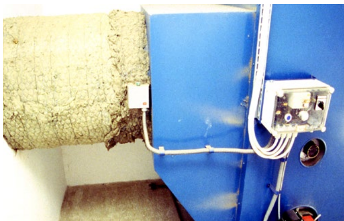
Varmluftskanalen i pannrummet ska alltid vara isolerad.
